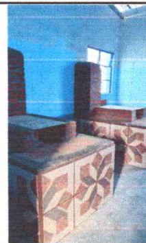
Foto 12: ESTUFAS RURALES NUEVAS, CON PLANCHAS Y CHIMENEAS DE LADRILLO.
